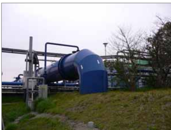
導水管の末端、ここから右の発電機に水が流れる
