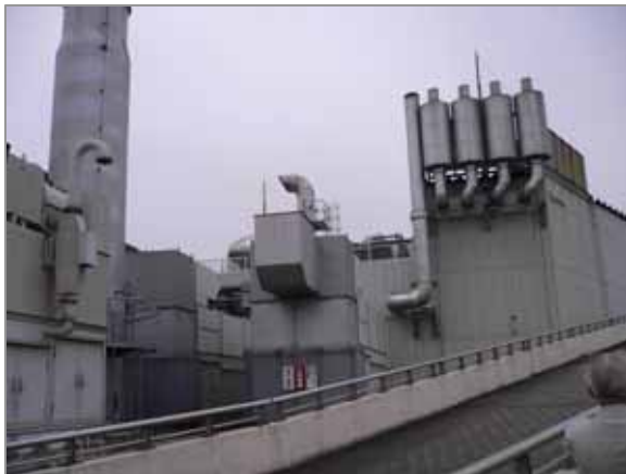
バイオマス発電建屋 屋上には黒い温水供給設備がある
