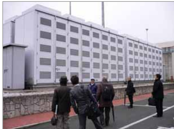
NAS 電池システム (2,000kW×4セット)
