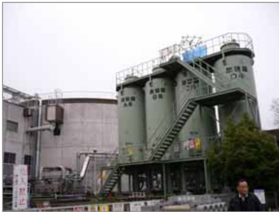
左の白い塔が汚泥消化槽 右側の緑色の塔が脱硫器
