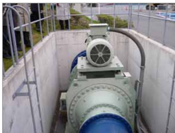
小水力発電機 すごい音がる 場周道路の脇にあり、道路の下を 通って発電後の水は運河に放流される。
