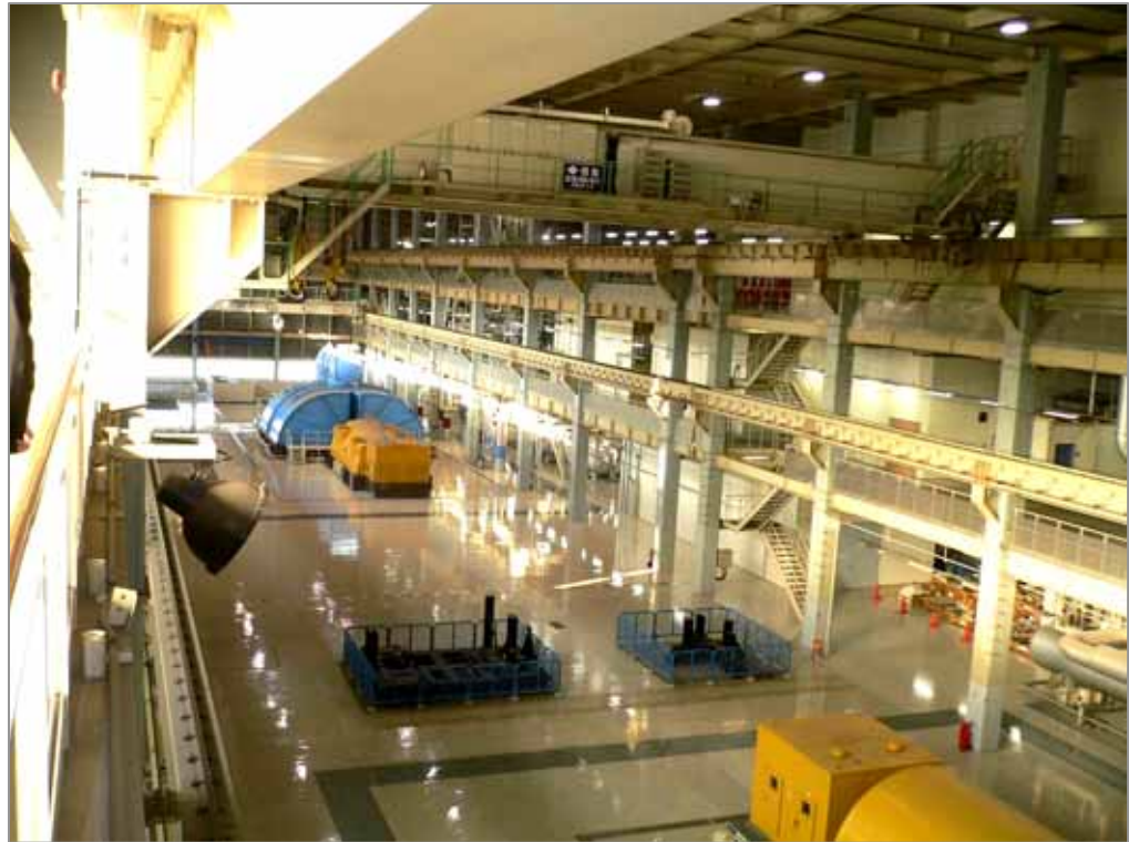
工場内の発電機 奥が2号機、手前が1号機
