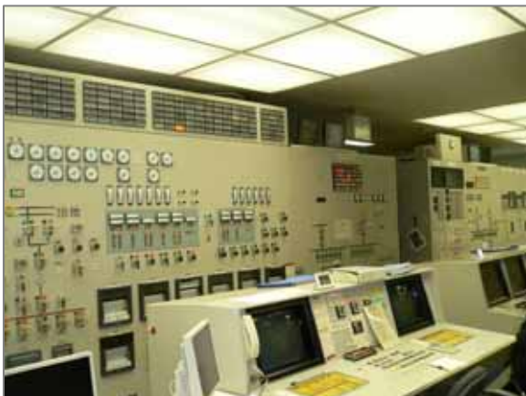
中央制御室 1～4号機を管理している
