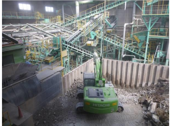
廃コンクリートリサイクルプラント
