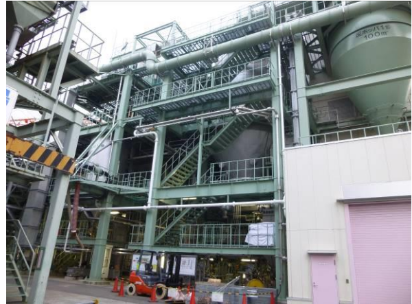
焼却炉、バグフィルター、過給機が設置された解放式の建物
