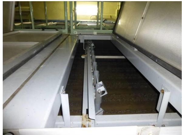
ベルト濃縮機 (内部)
